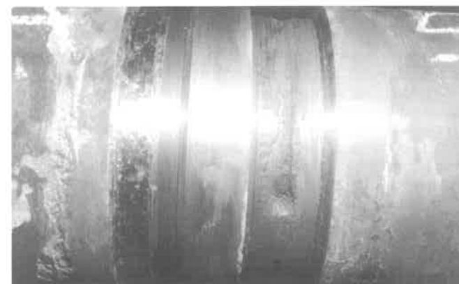
Corrosiones en la zona entre camisas por rotura del material entre ambas
