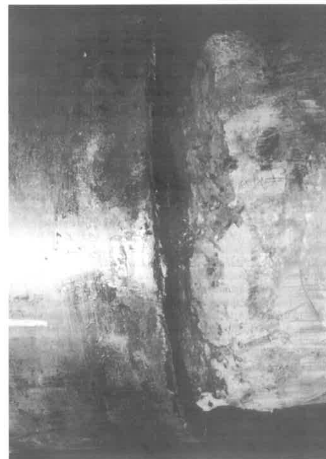
Filtración de agua bajo la camisa debido a un defectuoso montaje del poliéster.
